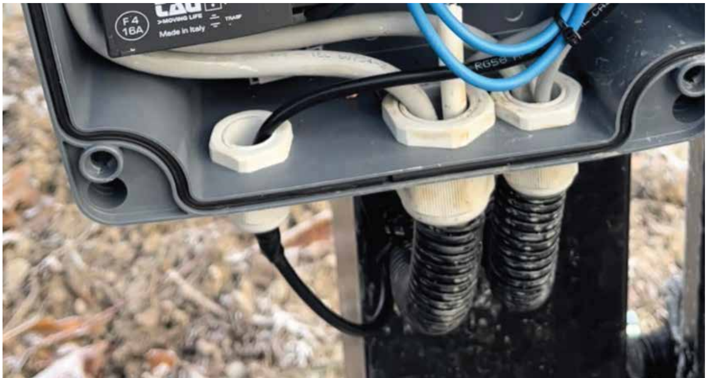
Bilden visar en kabeldragning från styrskåp in i stolpe.
